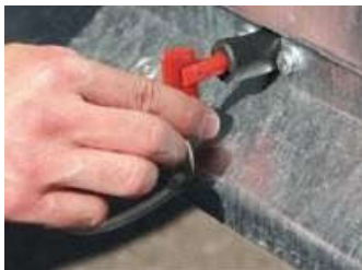
Bild 6: Hauptschalter auf AUS gestellt
