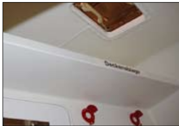
Ablage über Durchgangstür
